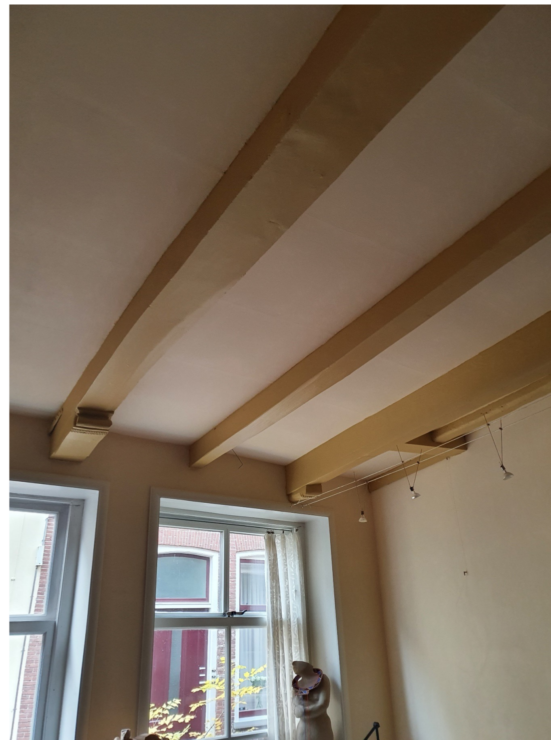
De kleine console van balk 1 vanaf links (vanaf de straat gezien) en het sleutelstuk van balk 3 zijn duidelijk verschillend en horen niet bij elkaar qua bouwfase.
