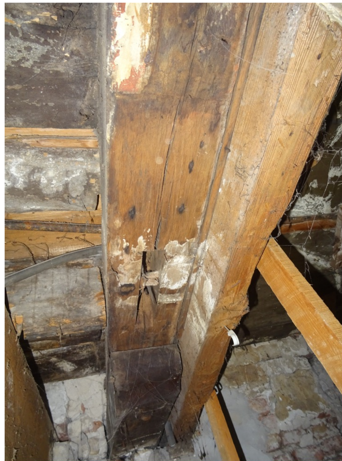
Begane grond, achterkamer: eiken dekbalk met ingekort sleutelstuk en pengat van een verwijderd korbeel. Het zijn restanten van een muurstijlgebint uit 1472-73.
